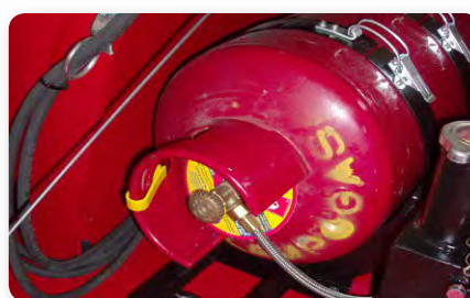
Impianto GPL LPG system Instalación de GPL
